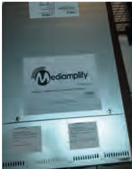
FIG 6. Unidad de exportation con MEDIAPLUG a un operador de cable
